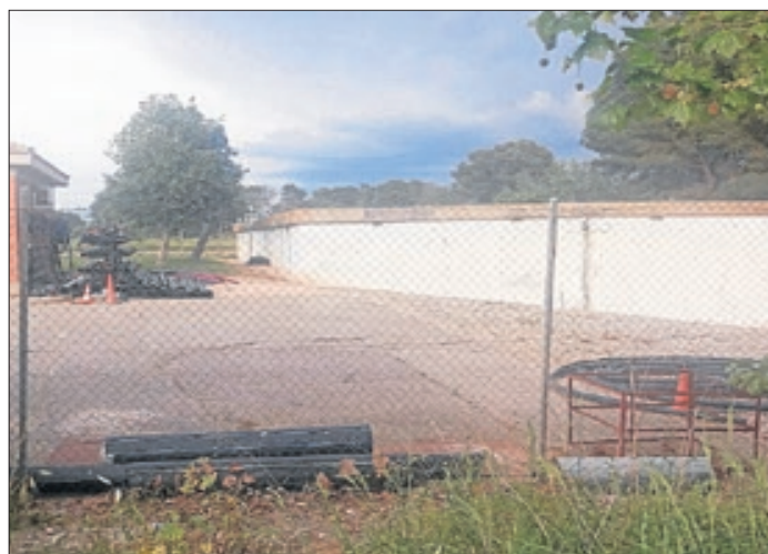
El depósito fuera de servicio es el mayor de los dos.
